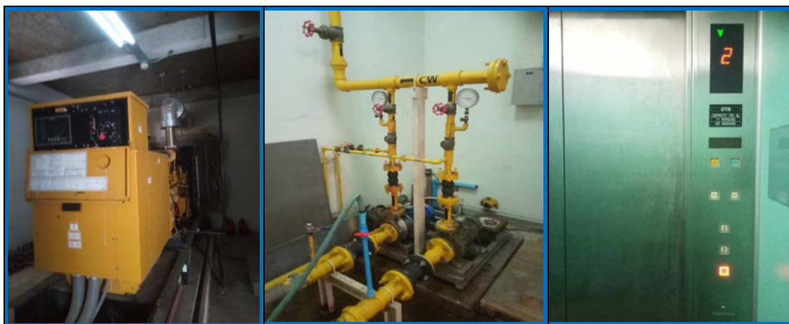
ภาพที่ 2.43 ระบบสาธารณูปโภค (ระบบไฟฟ้าสำรอง ปั้มน้ำสำรอง และลิฟท์) ของคณะฯ
